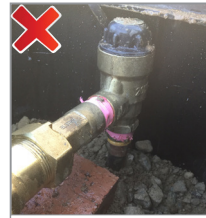
PRV in box
